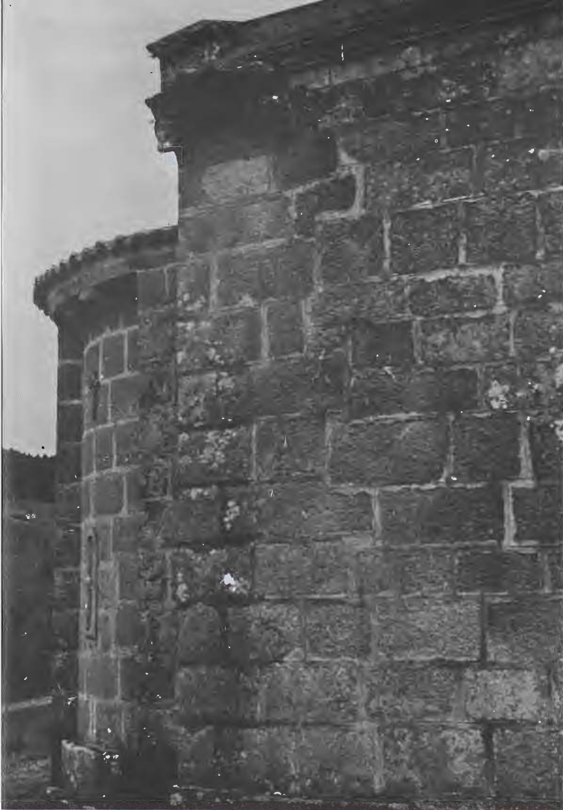
Iglesia parroquial de Santa María de Cuiña (La Coruña). Las reformas efectuadas en 1934 sustituyeron la primitiva cornisa sobre canecillos por otra de cemento. El cambio de obra se aprecia en la fotografía.
