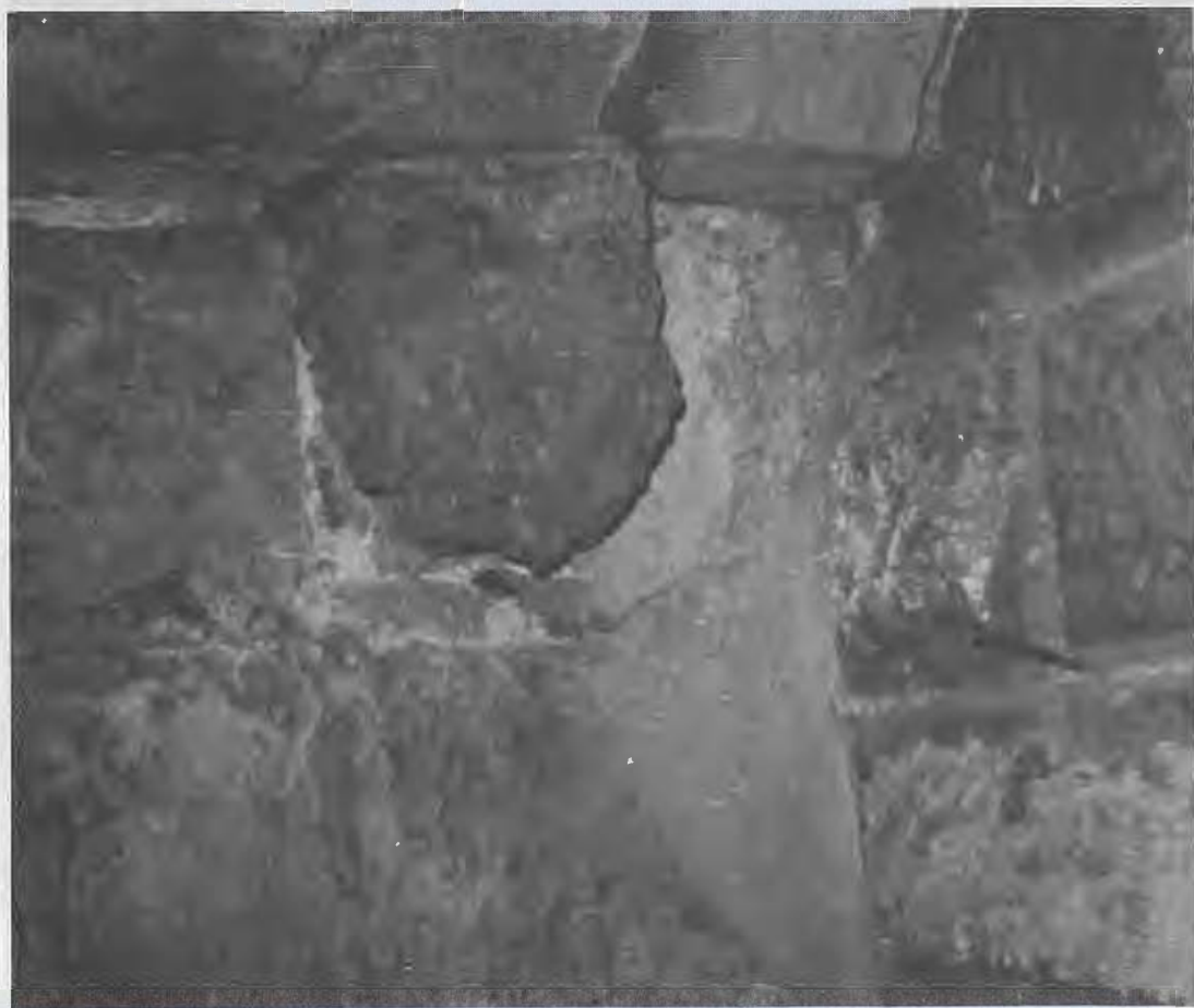
(Arriba): Vista lateral de la Portada mostrando la parte superior que acusa un notable desplome. (Abajo): Detalle del punto señalado con una flecha, mostrando una separación anormal de 10 cm, rejuntada con cemento.
